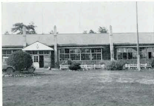
写真 1. 札友内小学校の傾斜した集合煙筒右（東側）のものほど傾斜が著しい
