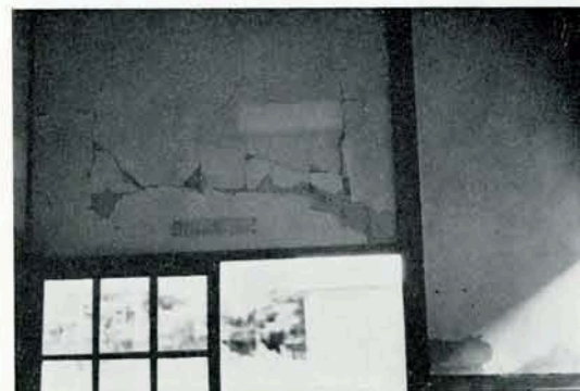
写真 2. 札友内小学校の壁の亀裂
