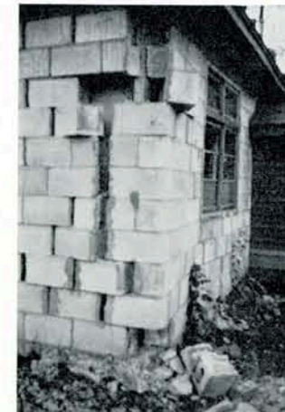
写真 10. 梅村氏宅ブロックの崩壊（家屋南西の角）
