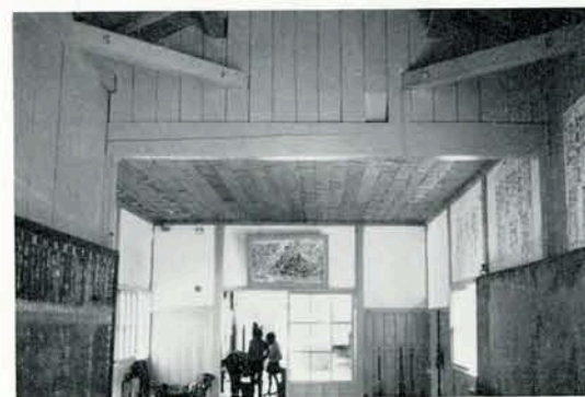
写真 3. 同小学校廊下はりのひび割れ（中央のはりに亀裂がみえる）
