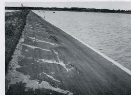
秋田県西部承水路堤防アスファルト面にきれ いに配列した盛り上り。
