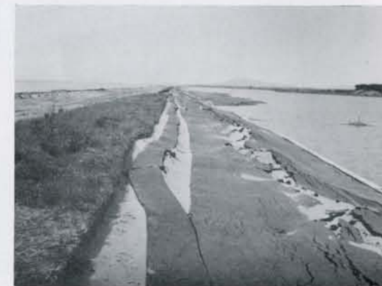
秋田県西部承水路堤防表面アスファルトの破 損状況。中央で堤防に平行してき裂し、そこ に周期的な盛り上りが見られる。
