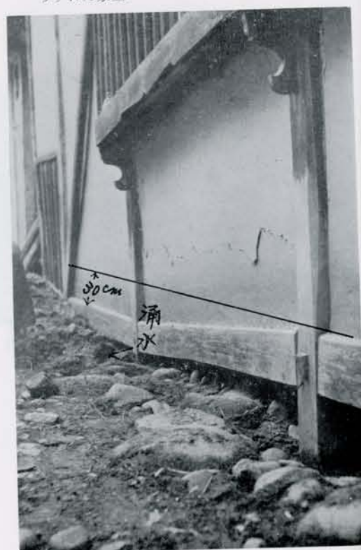
山形県遊佐町住家被害 1 部破損 (酒田測候所)
