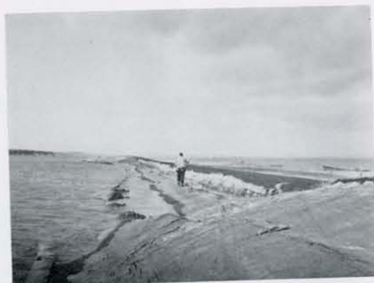
秋田県西部承水路堤防 WC14—WC15 の 中間点で最も沈下し、コンクリート矢板は 水中に没している、土で溢水を防いでいる。
