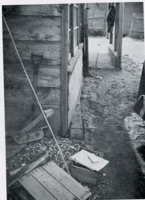
秋田県八竜村芦崎の住家被害状況。土台か らずれた家屋。
